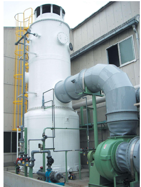
塩素ガス除害設備
